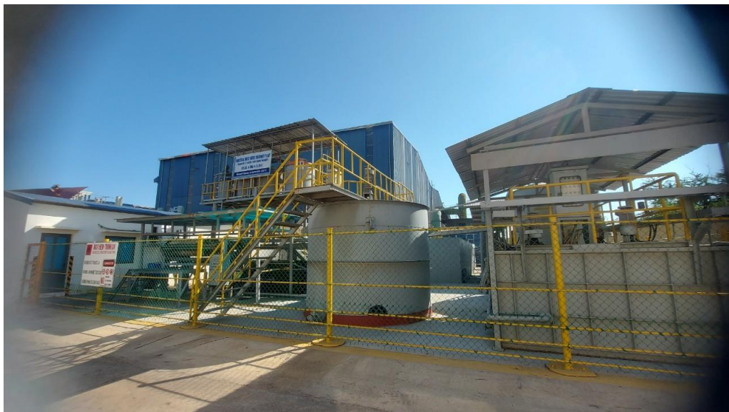
Hình 4.15 hệ thống xử lý nước thải sản xuất
